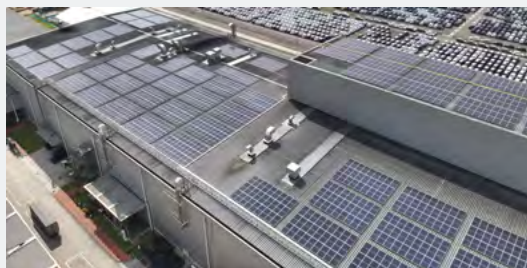
MMKIの塗装工場太陽光発電設備
