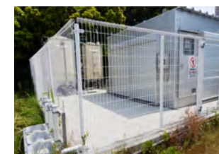
地下水膜ろ過設備(岡崎製作所)
