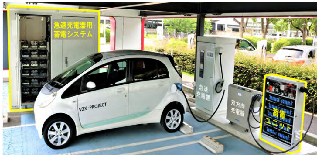
使用済みバッテリーリユース実証設備
