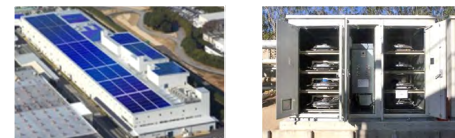
岡崎製作所(愛知県)に設置した太陽光発電設備および蓄電システム
