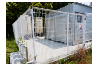
地下水膜ろ過設備（岡崎製作所）
