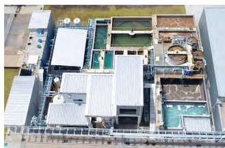
排水リサイクルプラント (MMTh)
