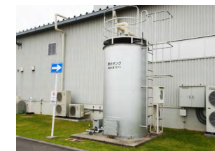
雨水貯留タンク（岡崎製作所）
