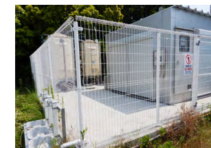
地下水膜ろ過設備（岡崎製作所）
