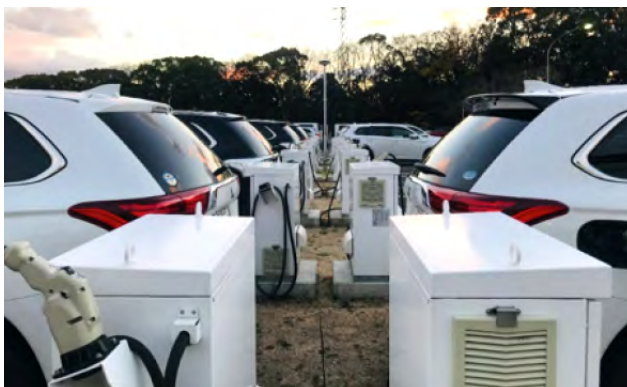
岡崎製作所従業員用駐車場に構築されたV2G実証サイト
