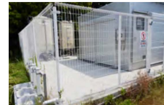
地下水膜ろ過設備（岡崎製作所）
