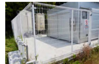
地下水膜ろ過設備（岡崎製作所）
