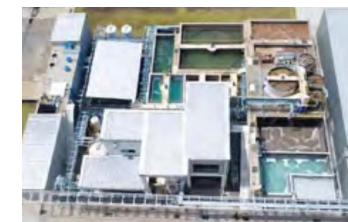
排水リサイクルプラント（MMTh）
