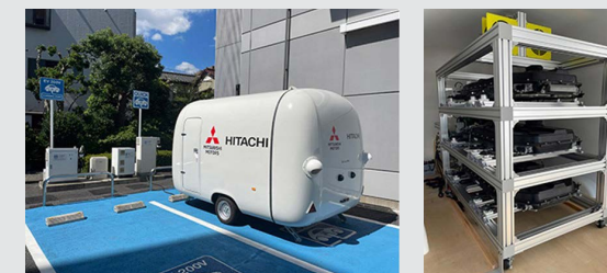
左：バッテリーキューブから給電している様子
