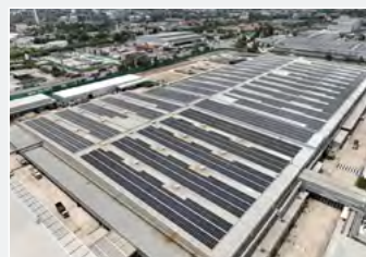
MMThの第三工場の太陽光発電設備
