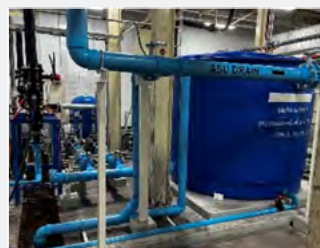
設置した結露水貯水タンク
