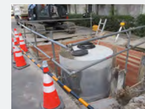
雨水の排水経路に設置したマンホール型油水分離ます
