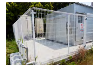
地下水膜ろ過設備（岡崎製作所）
