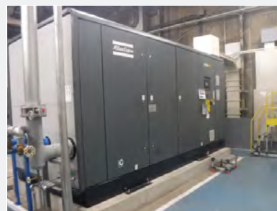
インバーター式に更新したコンプレッサー
