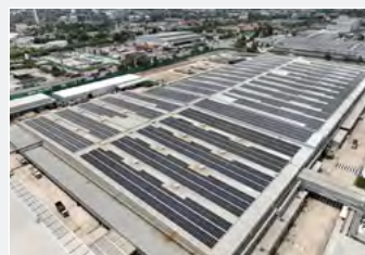
MMThの第三工場の太陽光発電設備
