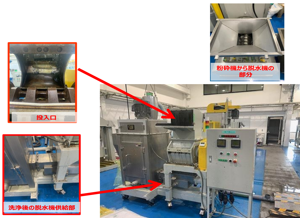
図 2-2. 洗浄粉碎設備 出所:いその
